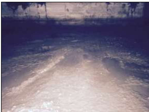
foto 30 Subsol înainte de igienizare
